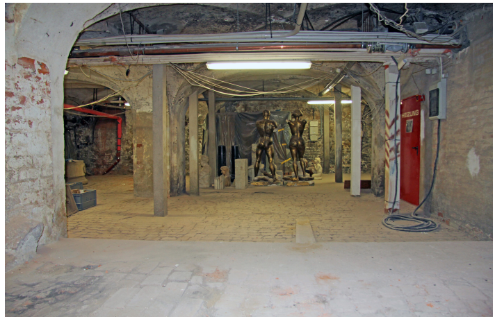
Gewölbe im Keller der beiden ehemaligen Kaufmannshäuser in der Königstraße 9 und 11. / Foto: Hansestadt Lübeck/www.luebeck.de
