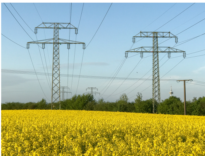
110 KV Leitung vom Umspannwerk Stockelsdorf nach Eckhorst. / Foto: Jörg Schiessler/Stodo.NEWS
