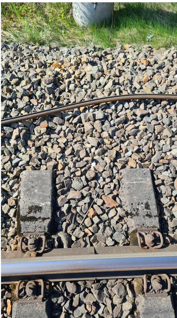
Fehlende Masterdung und aufgetrennte Isolierung. / Foto: Bundespolizei
